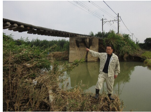
姿川決壊による東武鉄道橋梁崩壊等を調査する荒川議員
